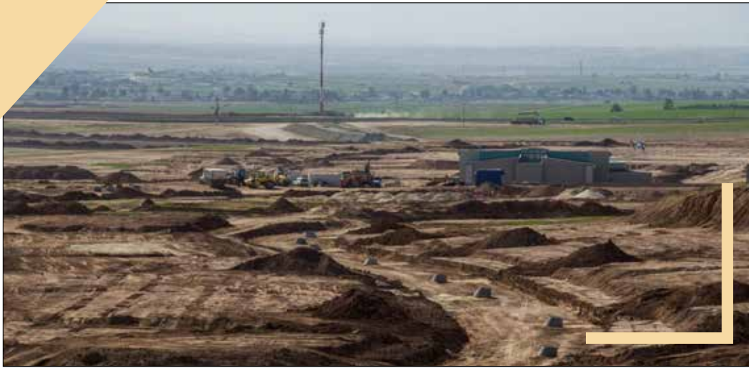
صورة 40: شبكات البنية التحتية للصرف الصحي في القرى اليهودية في النقب: البلدات اليهودية في النقب تتمتع بشبكة صرف صحي، حيث مع إقامة البلدة تقوم سلطات الاحتلال بتحضير البيوت وربطها بشبكة الصرف الصحي؛ هذه الصورة لإقامة بني تحتية وصرف صحي في بلدة كرميت اليهودية في النقب وكما يتضح البلدة ما زالت في طور البناء. (روتتم، ميخال، 2017)
